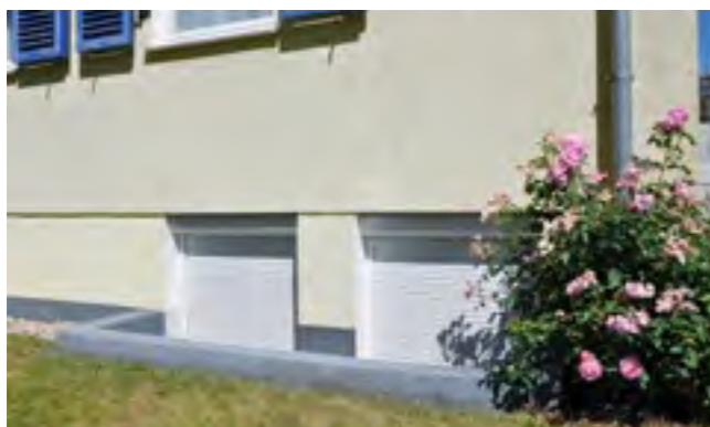
Abbildung 24: Aufkantungungen an Kellerfenstern. (© GEB)
