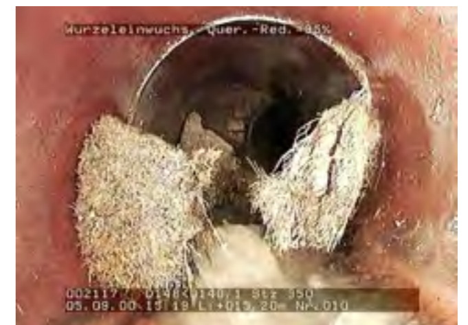
Abbildung 31: Ergebnisse einer Zustandsprüfung: Undichte Bestandsleitung mit eindringendem Grundwasser (oben); Wurzeleinwüchse (unten). (© GEB)
